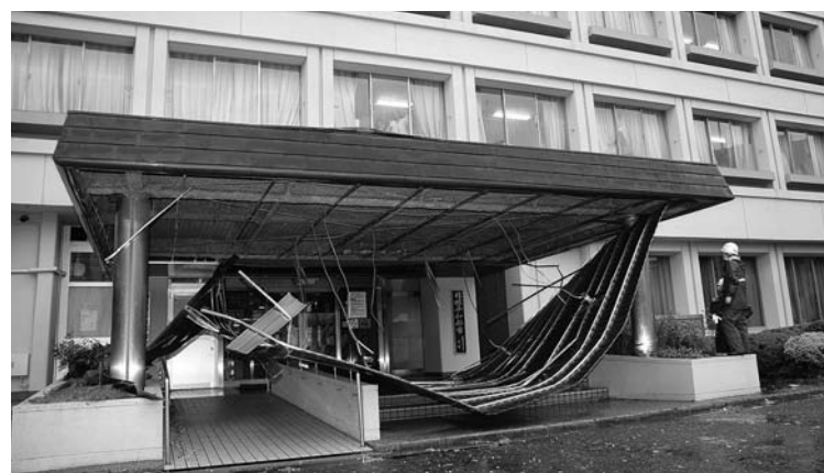
台風21号に被害を受けた市役所別館南館
