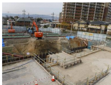
<津田低区配水場3号池>
