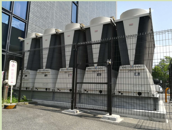
空調用熱源機(きらら)
