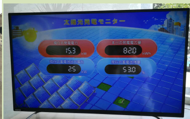
発電量モニター(きららエントランス)
