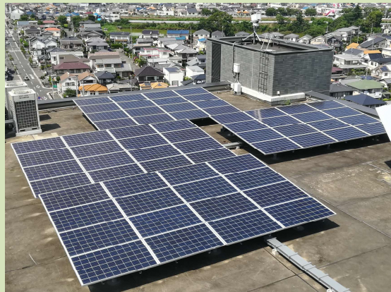
太陽光パネル 21.2kw(きらら屋上)
