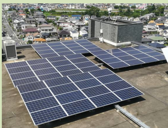
太陽光パネル 21.2kw(きらら屋上)
