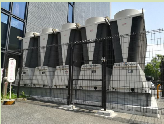
空調用熱源機(きらら)
