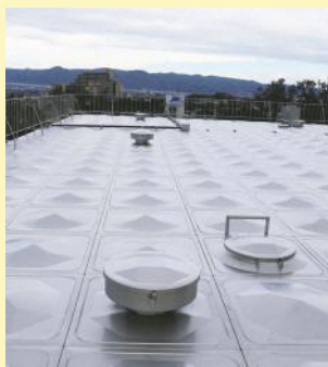
▲配水場の上には維持管理のため点検口などが設置されています。
