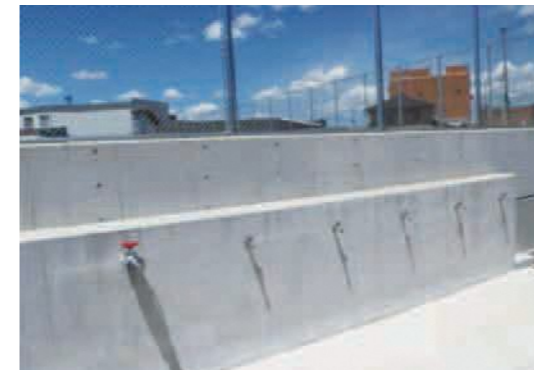
▲春日受水場(応急給水拠点として整備)の応急給水栓
