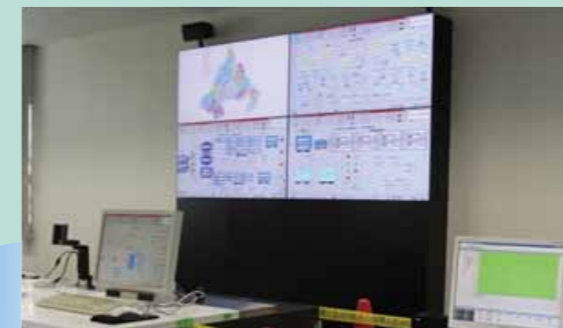
2階 中央操作室
