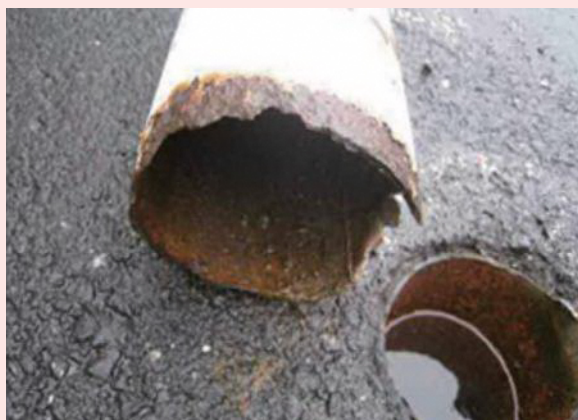
ポールの根腐れによる倒壊
