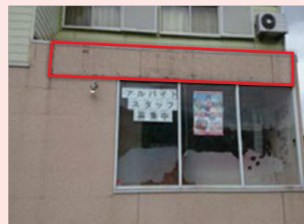
落下した後の壁面
