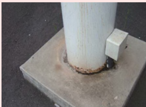
ポールの根元にサビが発生
