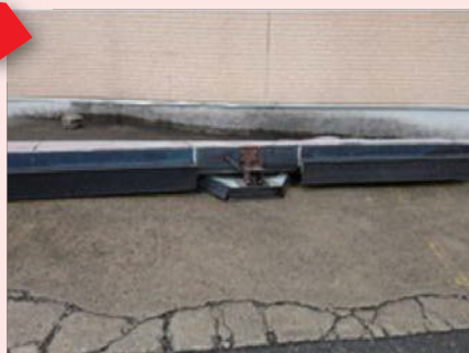
落下した欄間看板
