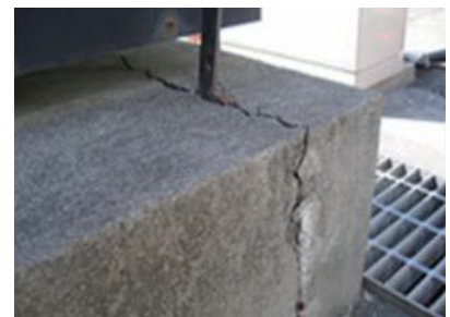
看板基礎のひび割れ
