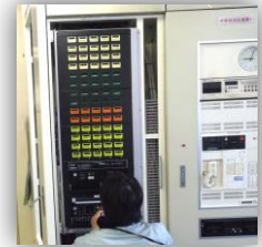
(事務所内の自動火災報知機)
