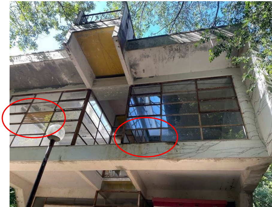
【第2研修棟の割れた窓ガラス】
