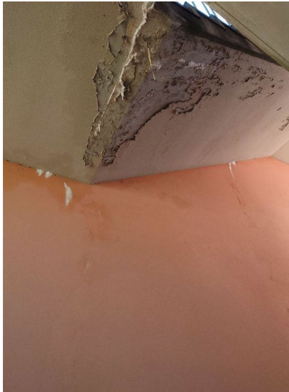
【中宮小学校 1 階避難階段 天井の剥離】
