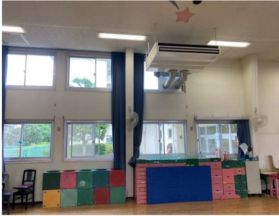
【遊戯室の天井吊りエアコン】
