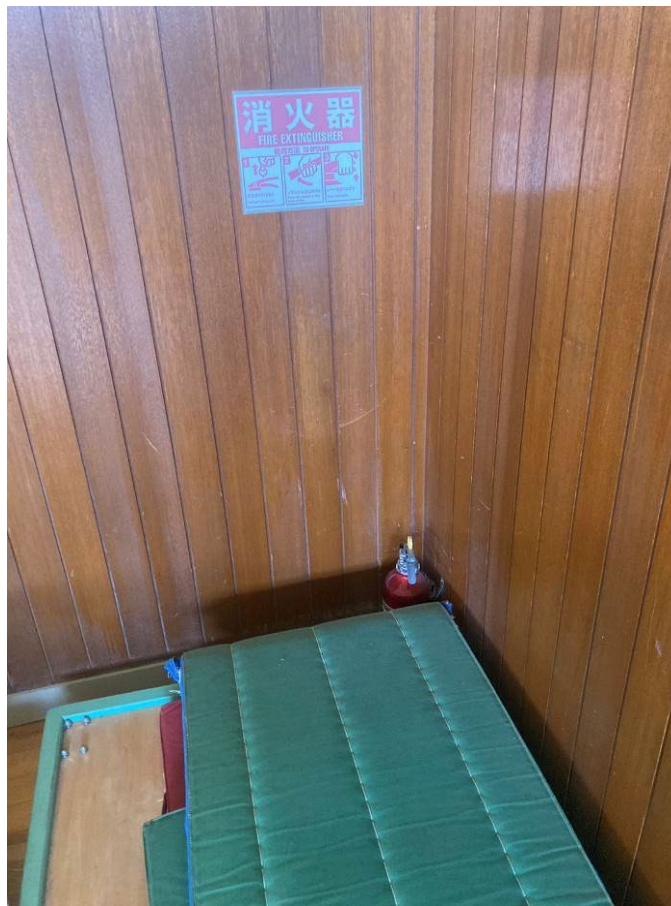
【藤阪小学校 消火器回りに置かれたマット】
