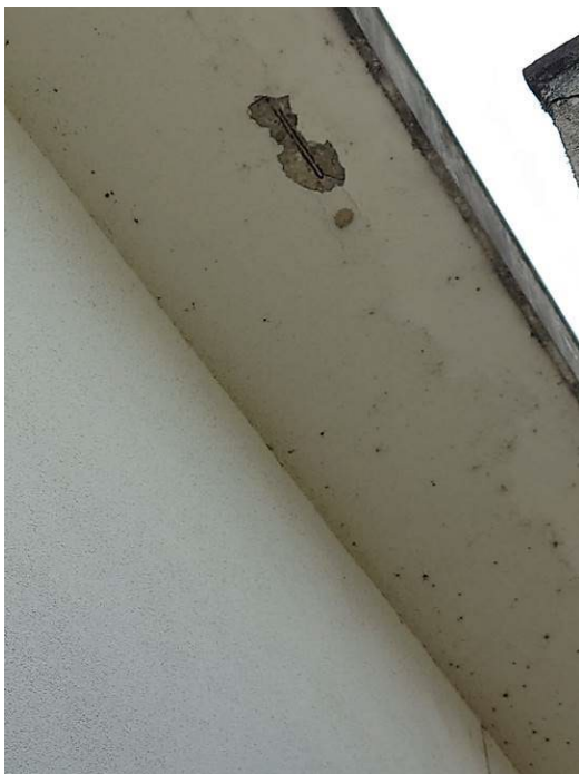
【磯島小学校 コンクリート剥離箇所】
