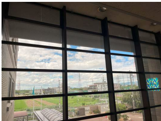
【エントランスの排煙窓】
