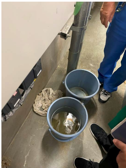
【6階機械室 結露による水滴】
