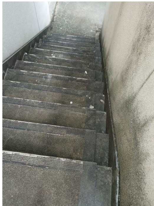
【磯島小学校 落下したコンクリート】
