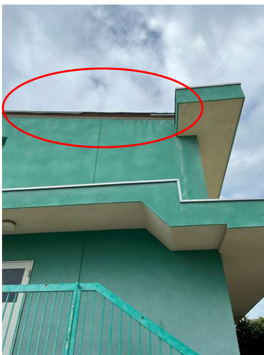
【体育館雨漏り箇所（外観）】
