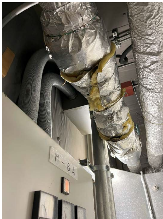
【6階機械室 結露箇所】
