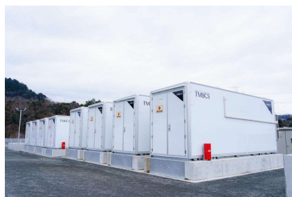
紀の川蓄電所
