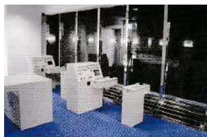
↑ クレーン操作室
