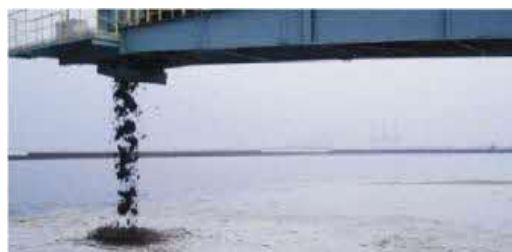
↑ 大阪湾フェニックスセンター
