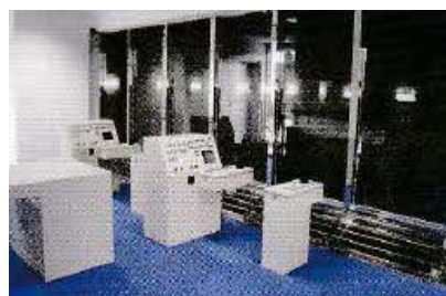
↑ クレーン操作室
