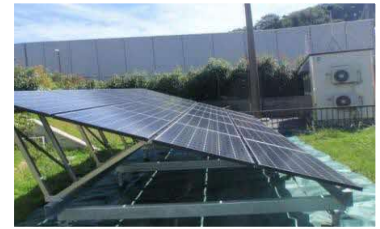
↑ 第二京阪監視局（津田局）太陽光発電システムを設置し、発電した電力を使用しています。
