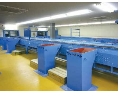
↑ 手選別作業室
