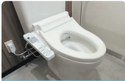
トイレのトラブル
