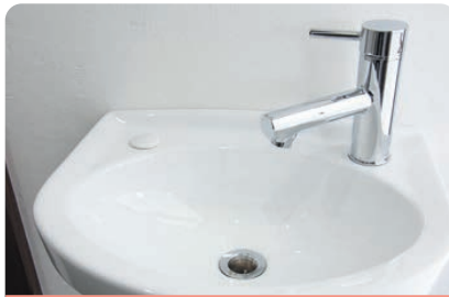
蛇口の水漏れ
