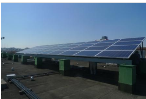
〈サプリ村野の太陽光発電設備〉
