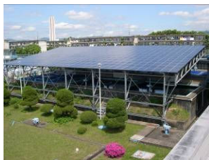
中宮浄水場 (60kW)
