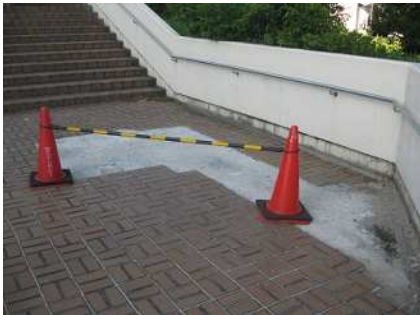
出入り口階段・床のタイルの剥がれ
