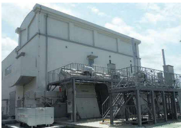
新安居川ポンプ場
