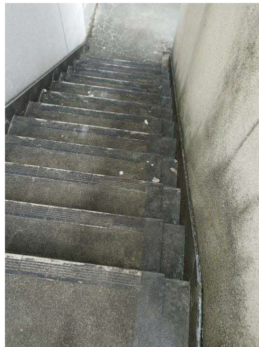
【磯島小学校 落下したコンクリート】
