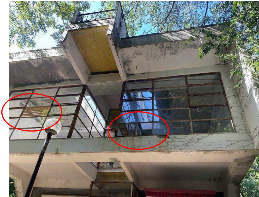
【第2 研修棟の割れた窓ガラス】
