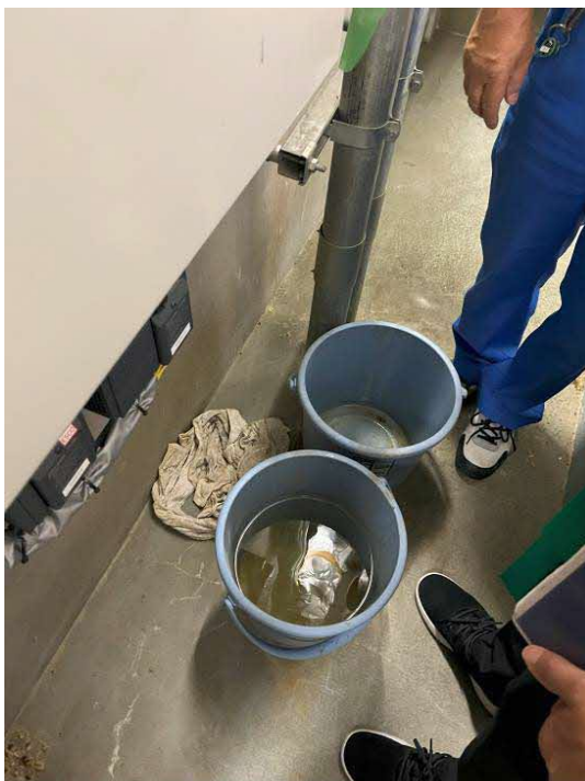
【6階機械室 結露による水滴】
