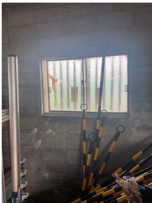
【蹉跎西小学校 割れ窓へのテープの貼り付け】
