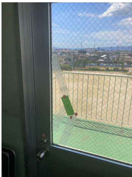
【津田小学校 割れ窓へのテープの貼り付け】
