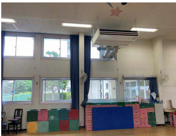
【遊戯室の天井吊りエアコン】
