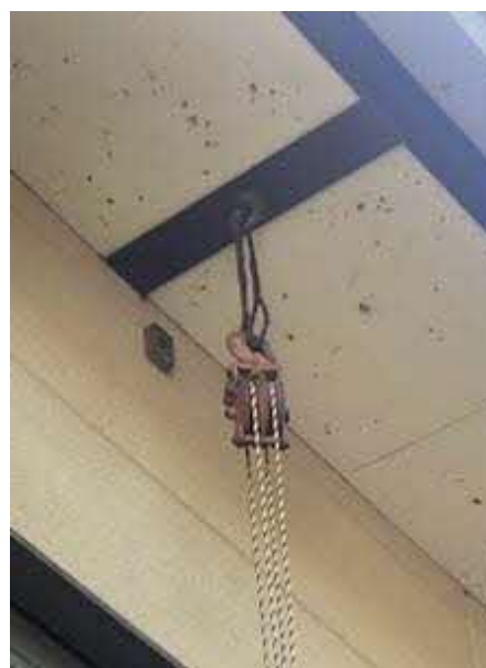
【収蔵用滑車劣化部分】
