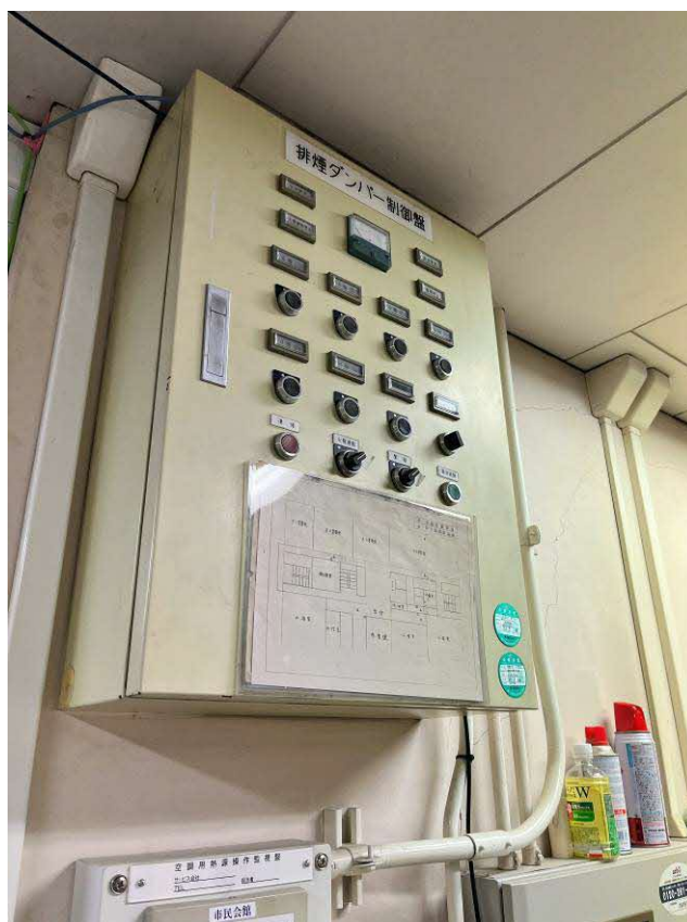
【排煙ファン操作盤】
