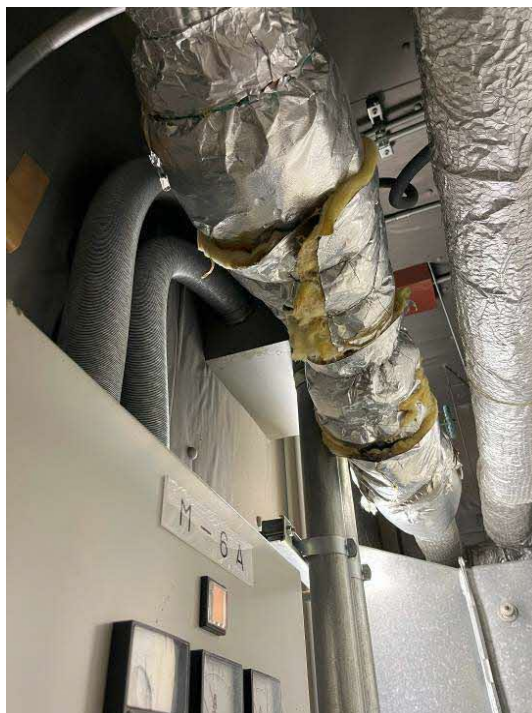
【6階機械室 結露箇所】
