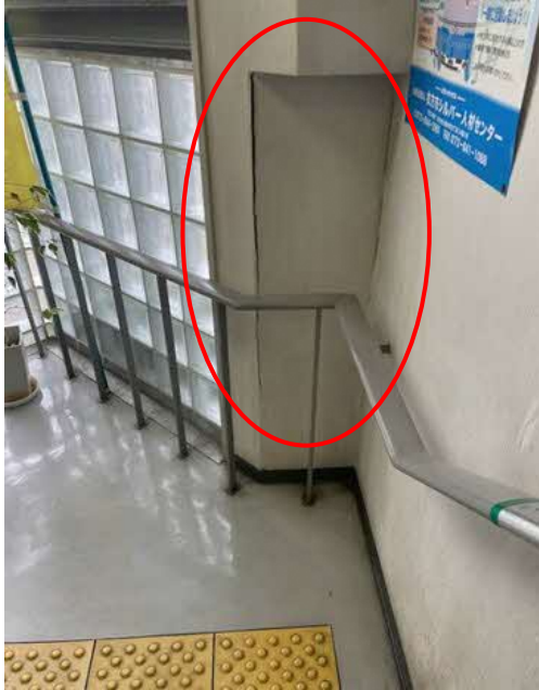
【壁のクラック】
