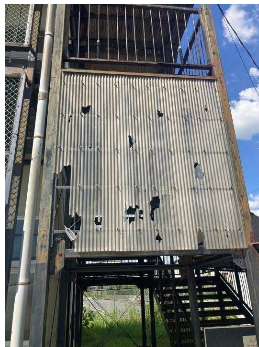
【津田小学校 プレハブ側面部分のポリカーボネートの破損】
