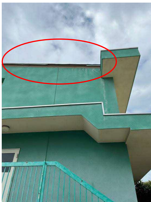
【体育館雨漏り箇所（外観）】
