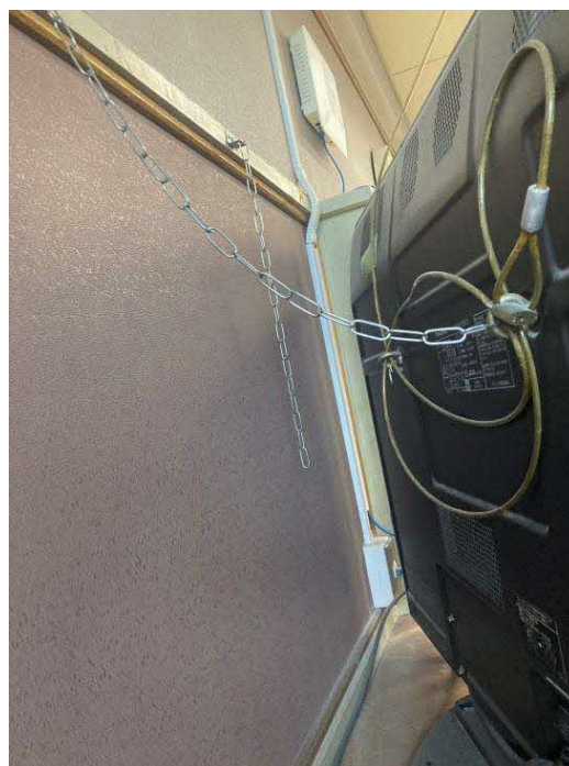
【蹉跎西小学校 テレビの落下防止用のチェーンの破損】
