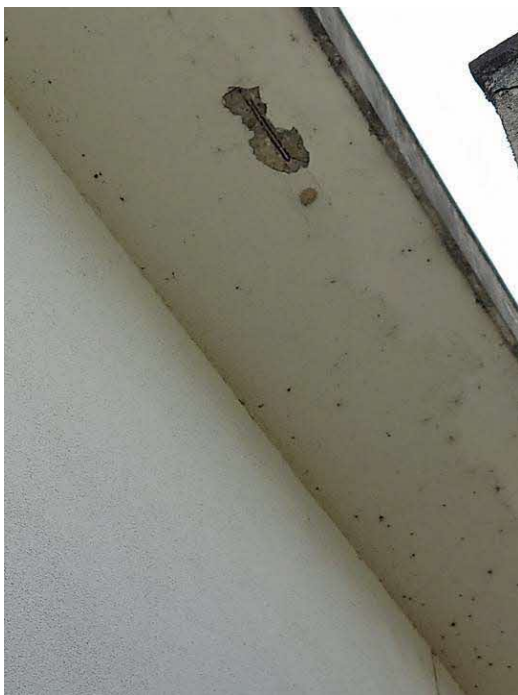
【磯島小学校 コンクリート剥離箇所】
