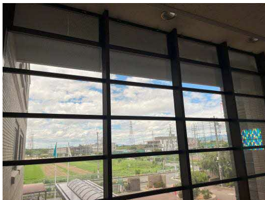
【エントランスの排煙窓】
